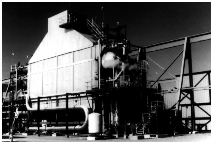
Figure 25. Forced-circulation HRSG with PG7111EA gas turbines
